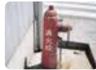
地上式消火栓
